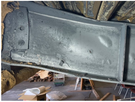
写真2 2021年度実験の無耐火被覆小梁端部の損傷状況
