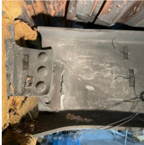
写真4 小梁接合部の損傷の様子
