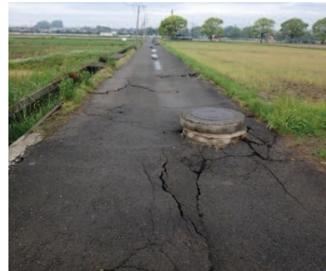
Photo.1 2016年熊本地震における埋設管理戻し部の陥没とマンホール突出
