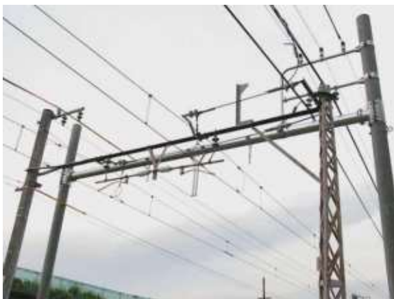
図 1 ラーメン電車線柱の例
